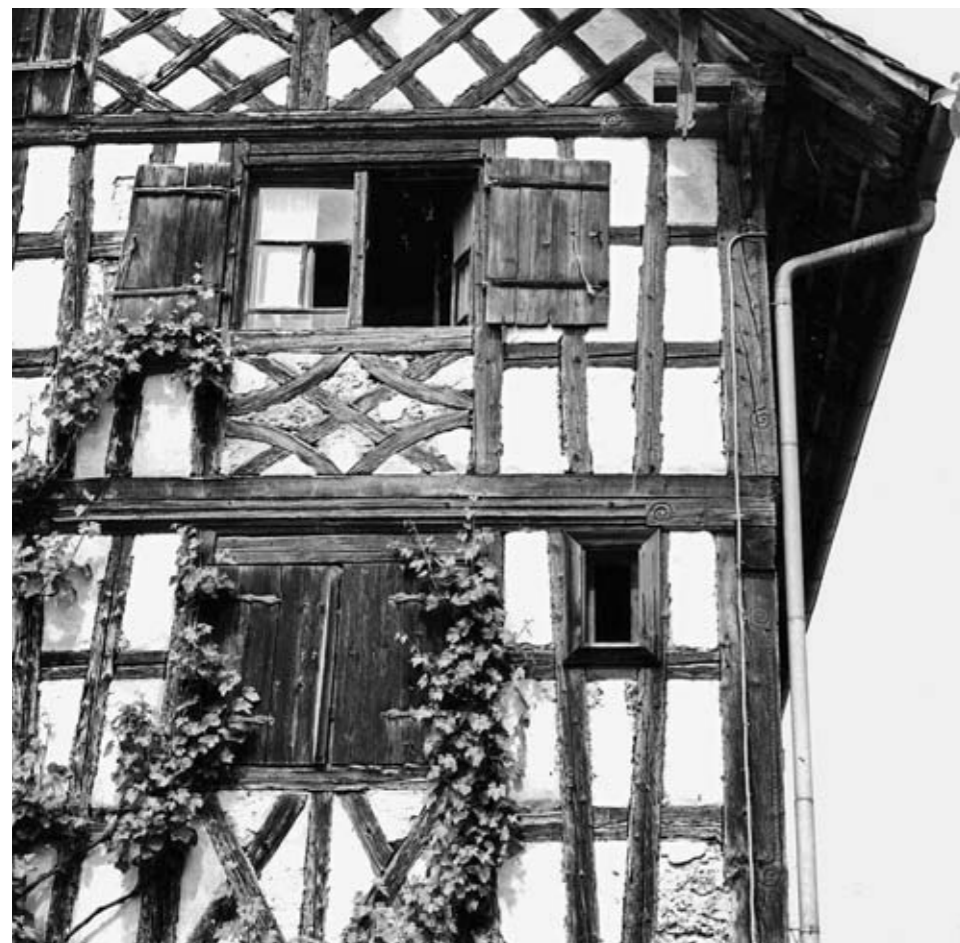
Holzspezifische Eigenschaften können geschickt ausgenutzt werden, so zum Beispiel Krümmwuchs für gebogene Streben und Trocknungsverzug für das Einspannen von Fachwerkfüllungen. Bild: Münsterlingen (TG).
